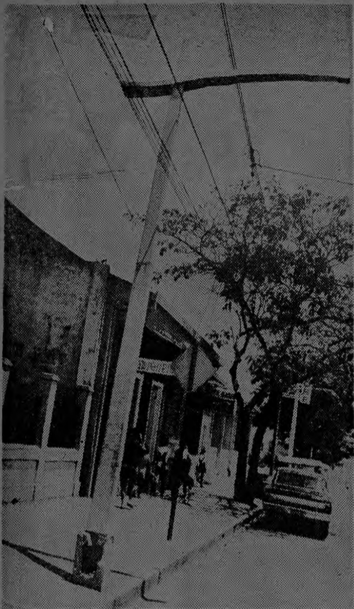
La presente gráfica muestra en toda su magnitud el grave peligro que encierra este poste situado frente a la Cancillería de Brasil, en el Paseo Colón. Nótese el estado de la base, su considerable inclinación así como la proximidad con las líneas de alta tensión. (Foto Córdoba).
